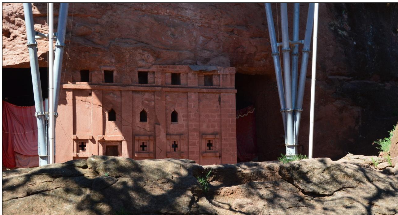
Fig. 53 – La chiesa Bete Abba Libanos, ricavata da una rientranza nella parete rocciosa. È visibile una crepa che si estende dal lato sinistro in alto e si propaga verso il lato destro, indizio di un danno di tipo strutturale. I pilastri in acciaio sorreggono la copertura installata a fini conservativi.
