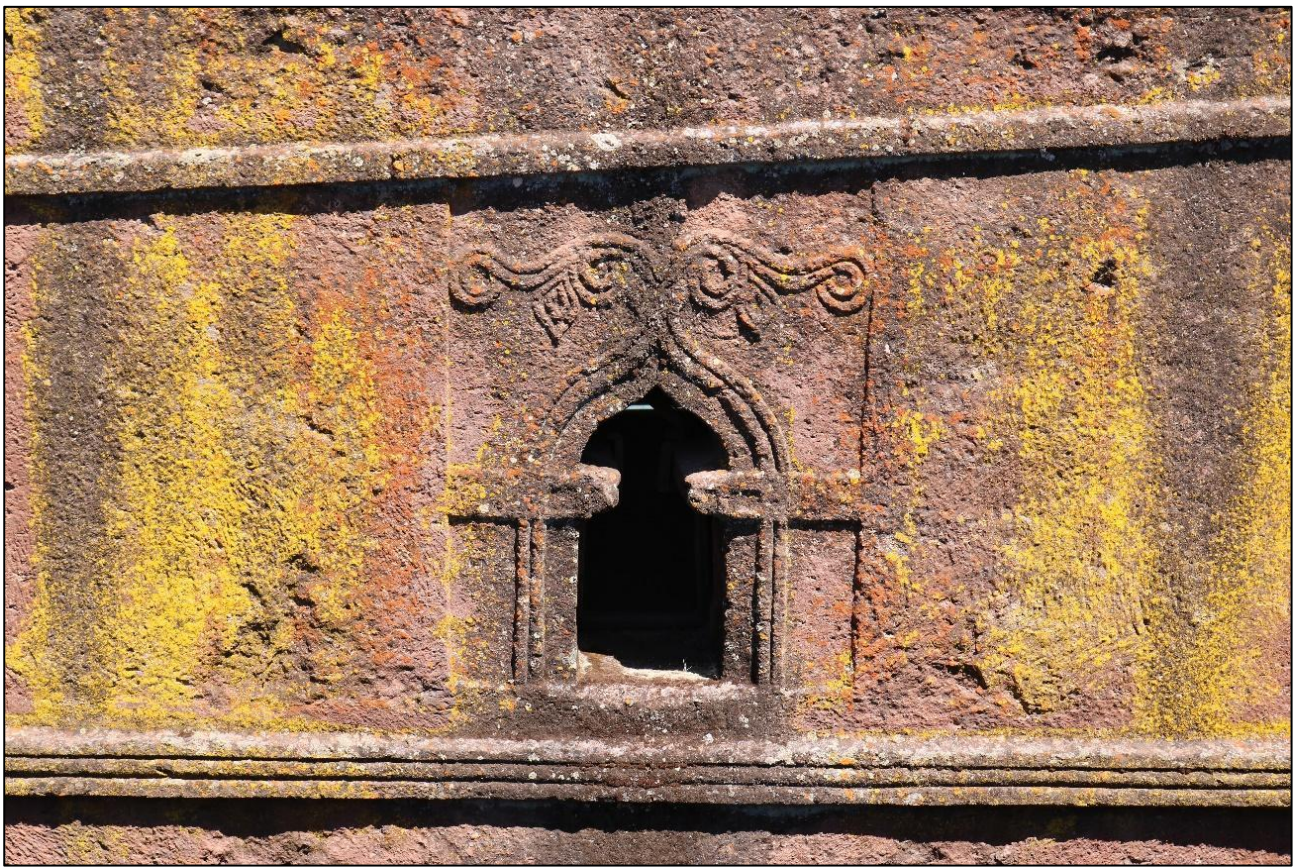
Fig. 56 – Colonizzazione lichenica che attornia una finestra del lato sud dell'edificio di Bete Giorgis.
